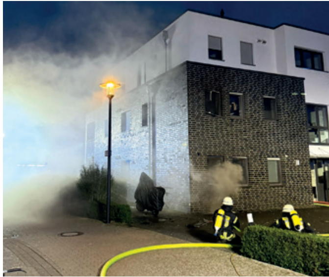
Starke Feuer- und Rauchentwicklung belastete die Löscharbeiten des Batteriespeichers im Keller der Wohnanlage. Nur massiver Wassereinsatz führte zum Erfolg.
