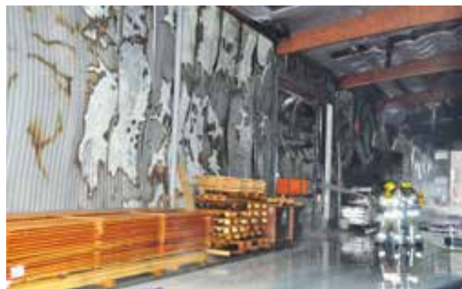
Unter Atemschutz sicherten Feuerwehrleute die angrenzende Lagerhalle vor einem Übergreifen der Flammen.
