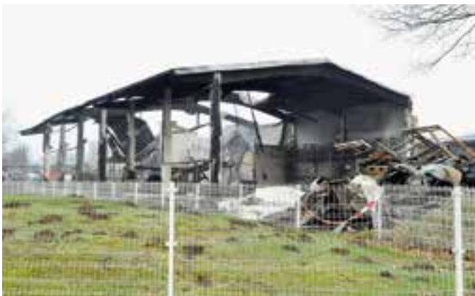
Am Tag danach wurde die Totalzerstörung beider Produktionshallen sichtbar.
