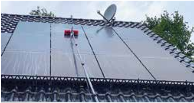
Die Leistungsfähigkeit der Solaranlage bleibt durch regelmäßiges Reinigen erhalten. Foto: Haubold Haustechnik
