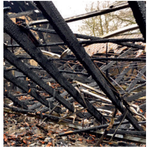
Unter den lodernnden Flammen stürzte das Dach, auf dem eine Photovoltaik-Anlage installiert war, teilweise, noch vor Beginn der Löscharbeiten ein.
